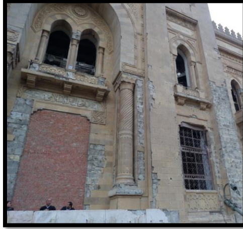
صورة (2) توضح بناء حائط (ساتر مؤقت) بدلاً من الباب الرئيسي للمتحف والذي تطاير إثر قوة الانفجار
