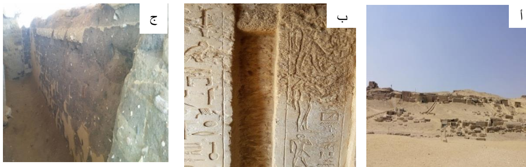
لوحة (أ) مواد بناء مقابر العمال بالجيزة، (أ) صورة عامة للموقع، (ب) ضعف وتقشر أسطح الوحدات الزخرفية، (ج) تدهور وتقشر السطح الخارجي لمواد البناء الطينية.
