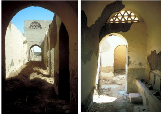
صور (١٣، ١٤) اساليب البناء بالخامات المحلية والطرق التقليدية لايجاد حل اقتصادي مع استخدام القبو المستطيل والعقود مع معالجة الفتحات المعمارية بالمثلثات المفرغة المنقولة من اهل النوبة ، مع التنوع فى اساليب البناء.
