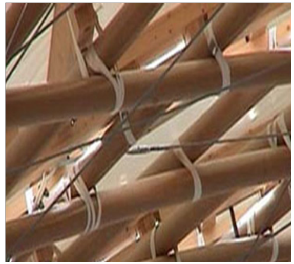
صورة (٢ ، ٣) جناح العرض الياباني في معرض " بألمانيا كمثال على العمارة "Hanover" الهاتوفر المستدامة، حيث تم بناء الهيكل من ورق صلب والأصعدة والكمرات من الخشب 1
