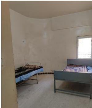
شكل (٢٦) يوضح عدم توافر إضاءة و تهوية طبيعية مناسبة وكذلك استخدام حوائط منحنية بوحدات الإقامة الداخلية
