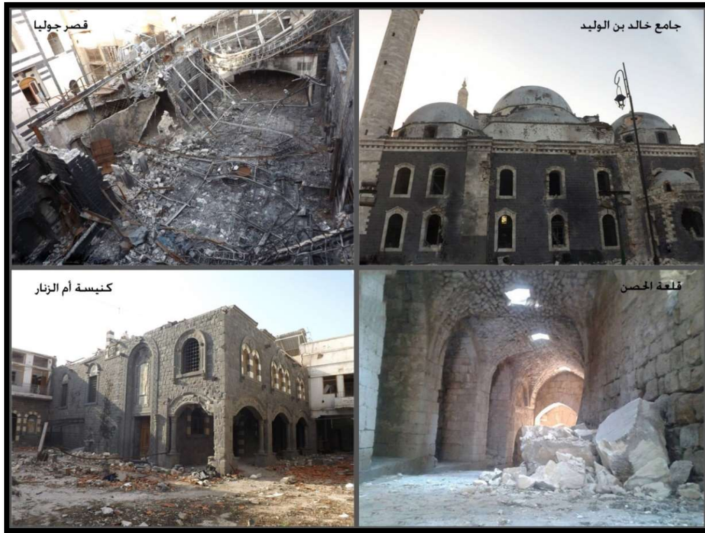
لوحة 10- الأضرار التي لحقت بمدينة حمص القديمة جراء الأزمة
