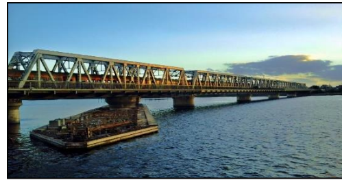
المصدر: الباحث، بتاريخ ١٠ أبريل ٢٠١٥. (صورة: ٢) كوبري دسوق، يمر عليه القطارات والسيارات والمشاة في اتجاهين.
