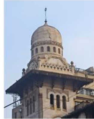
صورة (٢٩) منطقة الانتقال يعلوها ربة القبة وبها نوافذ صغيرة، يعلوها شريط جفت بارز، يعلوه خوذة قبة ملساء تنتهي بعمود ودائرة معدنية مفرغة كرمز للهِلال.
