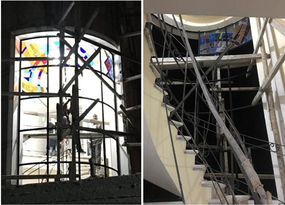
شكل رقم (٢١) يوضح الواجهة الزجاجية من الخارج والداخل اثناء التركيب وتظهر السقالات المستخدمة في التركيب (من تصوير الباحثة-٧-٢٠٢٢)
