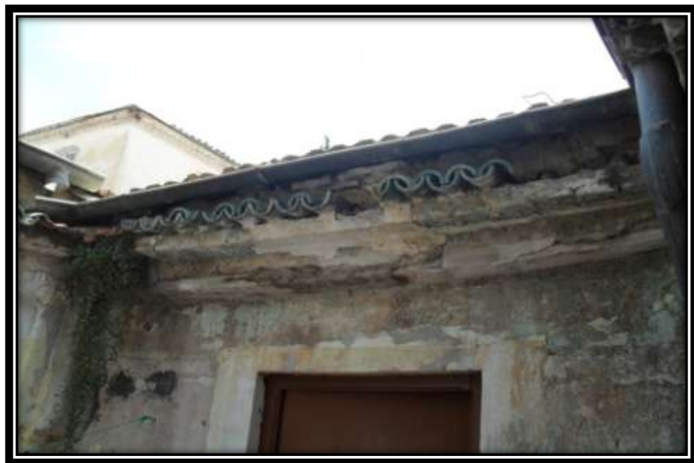
الصورة -٥- بعض أمثلة الضرر الذي لحق بمدسة سيدي الأخضر
