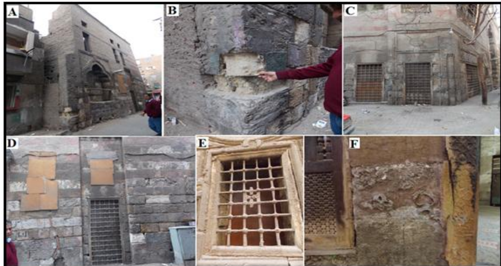
صورة رقم (٧ - A,B,C,D,E) توضح والتعدى ببناء عمارة حديثة ملاصقة تماما للمدرسة A - فقدان في بعض أجزاء من المداميك الحجرية B - انخفاض منسوب ارضية المسجد عن منسوب الشارع C - صدأ حديد الشبابيك وتغطيته بطبقة سودا D,E - تدهور حالة الأخشاب بسبب الرطوبة والاملاح F. ( تصوير الباحث )
