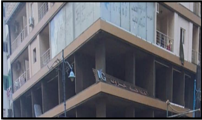
صورة (2) مبنى من الطوب الأسمنتي بشارع الإسكندرية في منطقة الأوقاف
