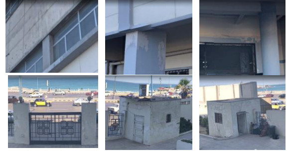
شكل (3) تلف طلاء واجهات بعض المباني الخدمية بمنطقة
