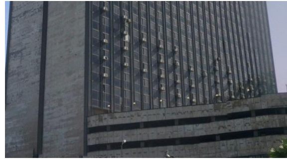
شكل (5) تلف واجهات المباني نتيجة لعوامل الرطوبة المصدر: تصوير الباحث من موقع الحالة الدراسية
