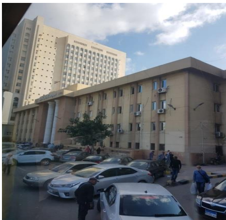
شكل (2) تلف ألوان التشطيبات الخارجية للمباني بتعرضها لأشعة الشمس، المصدر: تصوير الباحث من موقع الحالة الدراسية
