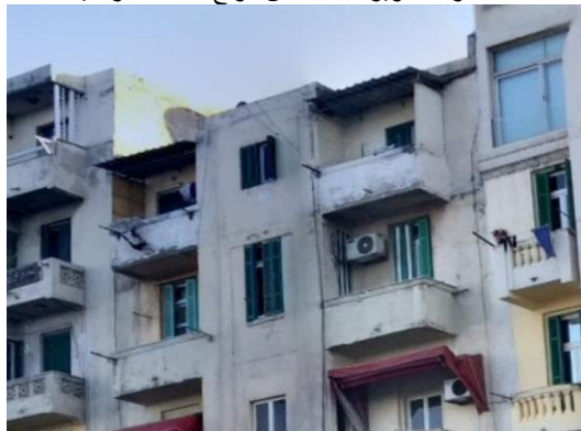
شكل (8) تلف واجهات المباني السكنية بمنطقة الدراسة
