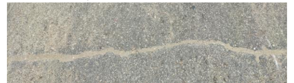
Fig. 8. Transverse crack No.7.
