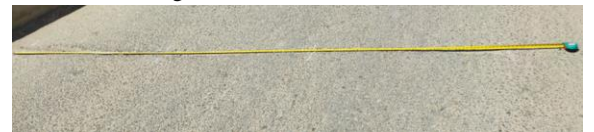
Fig. 9. Transverse crack No.8.
