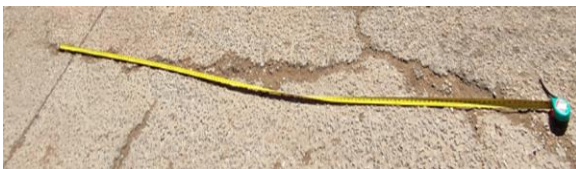
Fig. 2. Longitudinal crack No.1.
