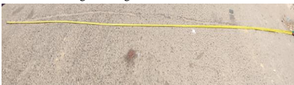
Fig. 3. Longitudinal crack No.2.
