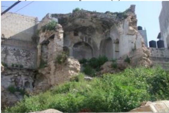
شكل(4) صورة انهيار أحد البيوت الأثرية بسبب القصف – المصدر: الباحث
