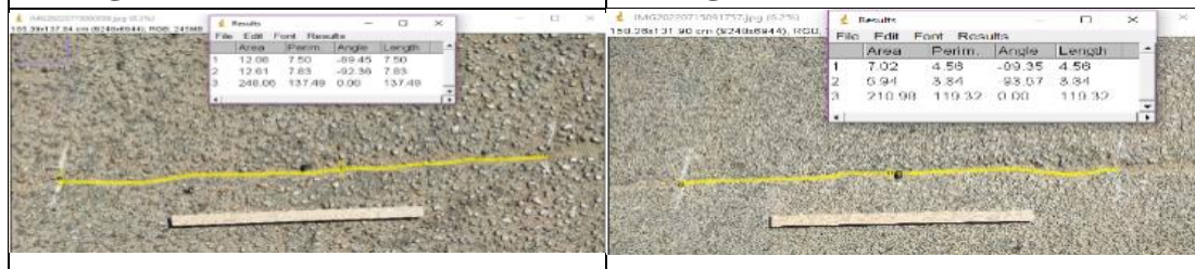
Fig. 22. Transverse crack No.7.
