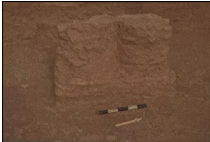
لوحة رقم 22: عمودان مزدوجان من الأجر لحمل الأسقف الخشبية. (العبودي، عمارة مدينة فُرح، ص 94).
