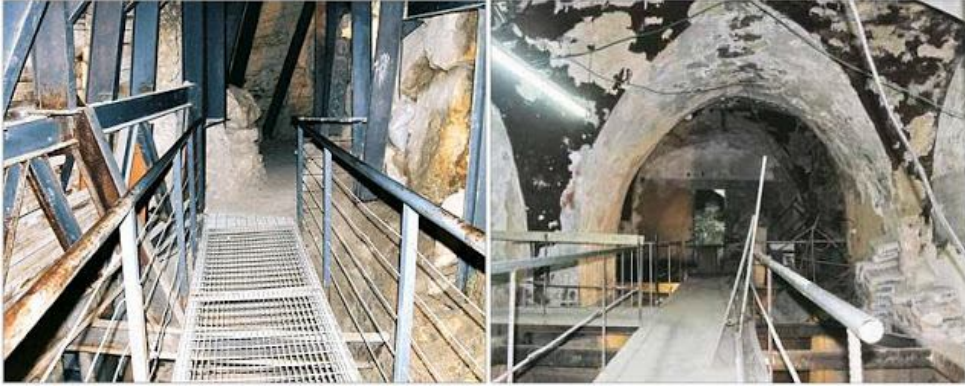
شكل ١٣: بناء الجسر الحالي (جسر المغاربة) إثر انهيار الجسر الاصلي بداية عام ٢٠٠٤، وذلك بسبب الحفريات الاسرائيلية ١٨ .
