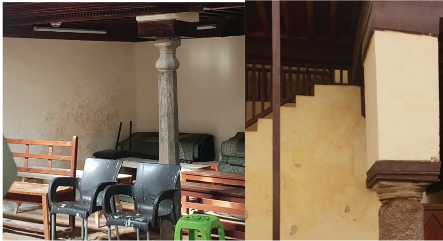
صورة (٥) تأثير مياه الأمطار على الحوائط الداخلية للمبنى على هيئة بقع رطبة في
