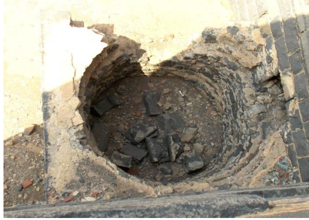
(لوحة ٤٧) فوه بئر المياه الملاصق للواجهة الجنوبية الغربية للكنزة العسكرية المحصنة بمحطة اصطبل عنتر (تصوير الباحث)
