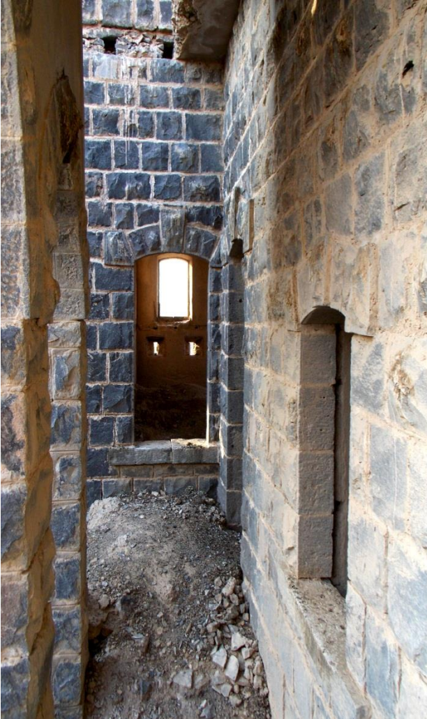
(لوحة ١٥) الممر الرئيسي الذي يتقدم الحجرتان والمطبخان والمرحاضين بالجهة الجنوبية الغربية للدور الأرضي للكتلة العسكرية المحصنة بمحطة مخيط (تصوير الباحث)
