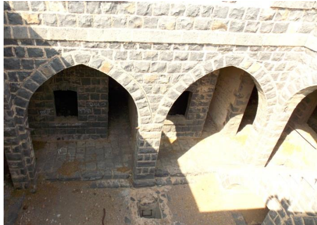
(لوحة ٣٨) البائكة التي تشرف على الفناء من الجهة الجنوبية الغربية للدور الأرضي للثكنة العسكرية المحصنة بمحطة اصطبل عنتر (تصوير الباحث)
