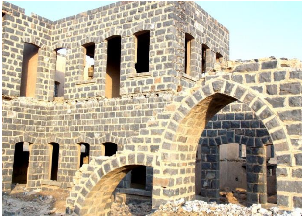
(لوحة ١٠) بقايا البانكة التي تشرف على الفناء من الجهة الشمالية الغربية للدور الأرضي للثكنة العسكرية المحصنة بمحطة مخيط (تصوير الباحث)
