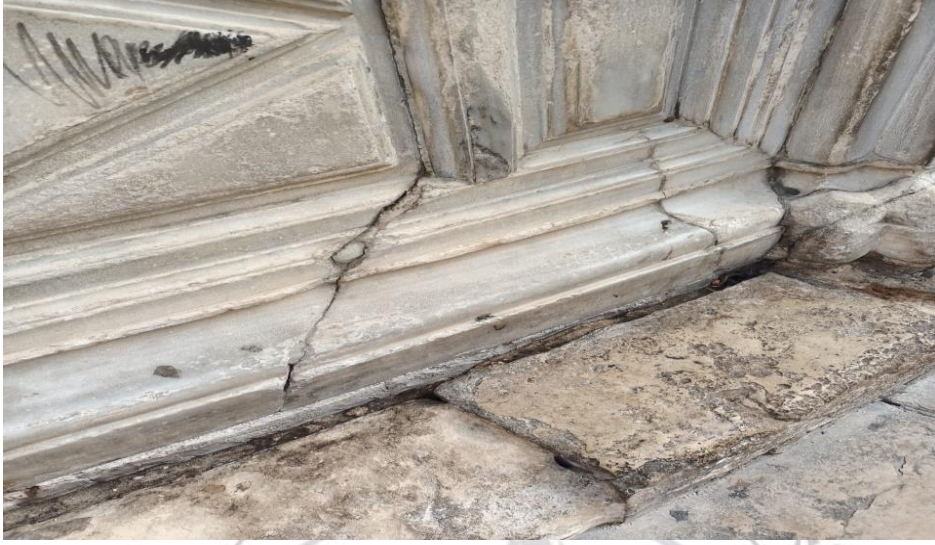
صورة رقم (2) توضح ارتفاع منسوب المياه الأرضية بالأرضيات والحوائط الرخامية (سبيل محمد على بشارع المعز بالقاهرة)
