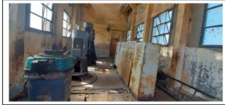
صورة (٣) محطة رفع مياه الصرف بمزرعة برسيق يونيو ٢٠٢٣
