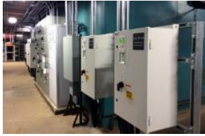
شكل (٨) أجهزة أتمتة المبنى في مبنى مبنى مركز الامتحانات بجامعة ترونو [٤٥]
