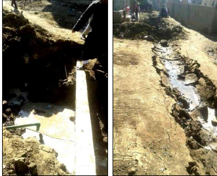
صورة (٢،١) انفجار مواسير مياه الشرب (قرية طملاي - مركز منوف)
