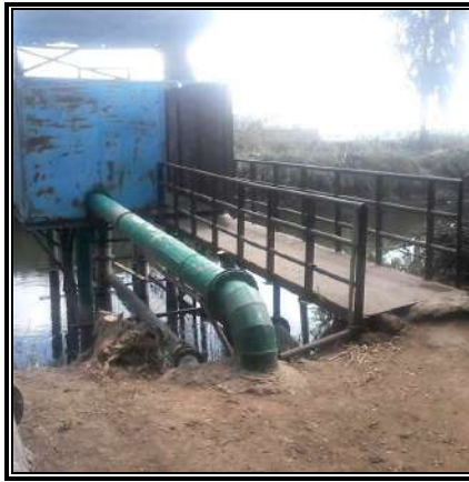
صورة (٢) مأخذ محطة شما المطورة (مركز أشمون) لتنقية مياه الشرب بتكنولوجيا الترشيح المباشر
