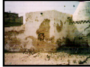
ضريح (قبه) مولى الربيع وتظهر في الصورة حالته بسبب الإهمال
