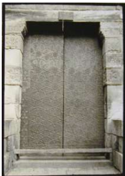
لوحة ٢ : باب المدرسة المنكوتمرية أعيد استخدامه في المدرسة المزهرية بالبعالة سنة ١٢٥١هـ
