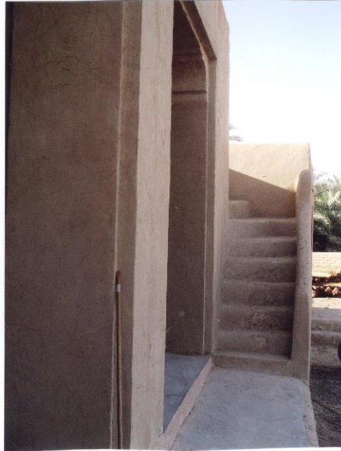
لوحة (4) درج فى الطرف الشمالى من واجهة مسجد محمد بن سرور الظاهرى يؤدى إلى سطح المسجد
