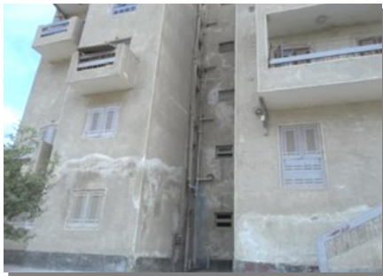
شكل رقم (11-ح) عمارة بمشروع إسكان مبارك بالمنيا الجديدة توضح مشاكل الصرف الصحي
