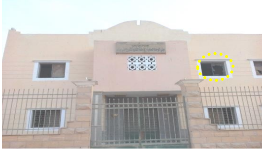
شكل رقم (11-د) وحدة صحية بمشروع ابني بيتك المرحلة الثانية - المنيا الجديدة "مغلقة" وتم تكسير الشبابيك بالمبنى"
