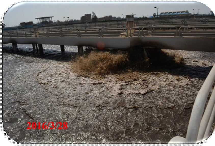
صورة (٥) أحواض تجفيف الحمأة بمحطة المعالجة.
