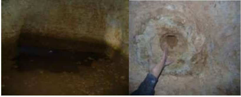
صورة (١٦) برك مائية بالنفق (٦) صورة (١٧) حفرة بسقف النفق (٤)
