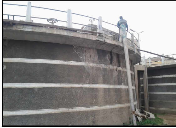
صورة (٣) : أحواض الترسيب (المروقات) بمحطة سمالوط.
