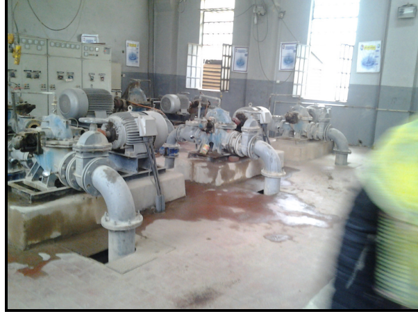
صورة (١) : ماكينات تشغيل رفع المياه من الببارة لأحواض الترسيب بمحطة سمالوط شرق.
