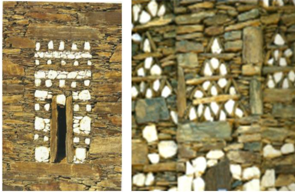
(شكل 5- أ،ب) رسات متنوعة بحجر المرّو الابيض تزيين واجهات عمائر قرية رجال المع
