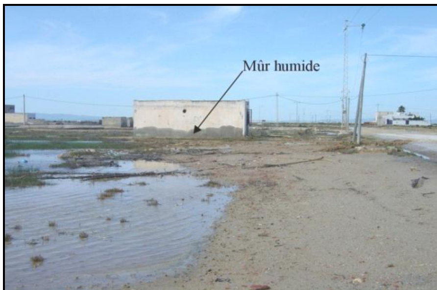
Photo (4): Au Nord de Raoued, des constructions menacées par l'humidité et installées sur un terrain gorgé d'eau plusieurs mois par an (W. Chouari, février 2006).
